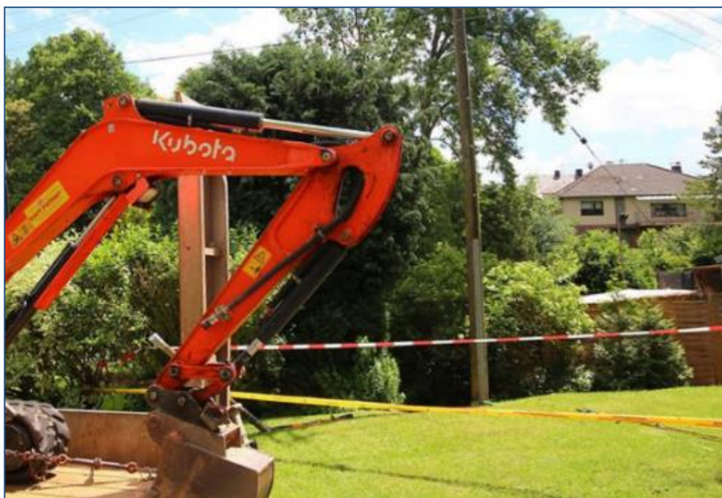
Abbildung 45: Foto des unterspülten Strommastes im Stadtteil Bleibuir in Mechernich 311
