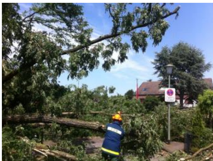
Abbildung 71: Aufräumarbeiten des THW nach einem Sturm 540
